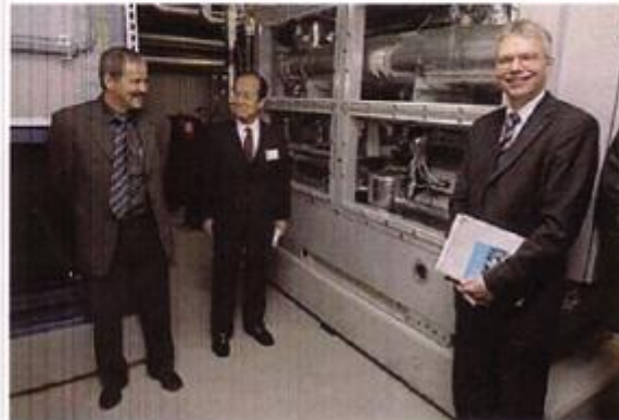
EWZ-Projektleiter Georg Dubacher (von links), Masao Maekawa, Vorsitzender der japanischen Firma Mycom, und EWZ-Direktor Conrad Ammann erläutern die CO2-Wärmepumpe. (David Baer)
