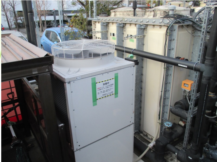
CO 2 冷凍機と蓄熱槽
