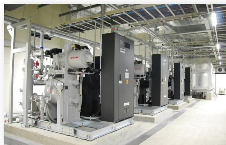
尾道冷凍流通センターのアンモニア/CO2冷凍機
