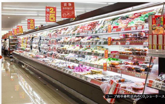
コープ府中寿町店内のCO2ショーケース
