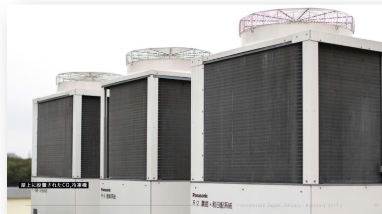
屋上に設置されたCO2冷凍機
