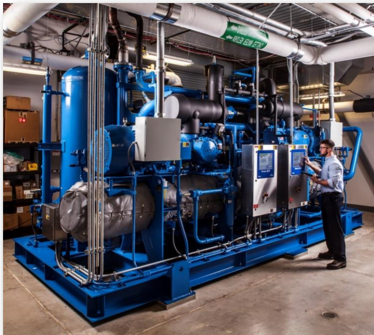
175 Ton R134a Chiller
