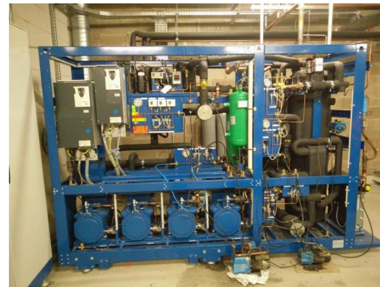
DC Rochefort CO 2 -cooling
