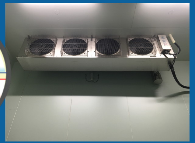
Chiller 冷凍冷蔵庫
