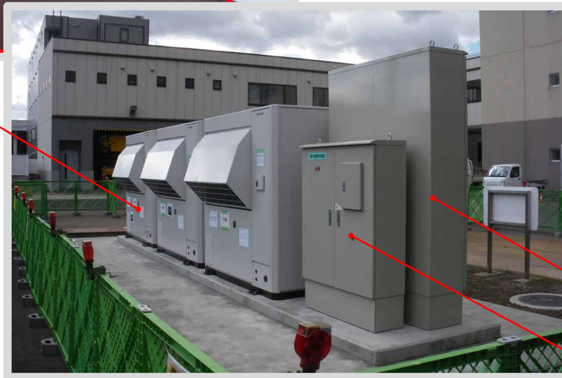
ヒートポンプユニット
