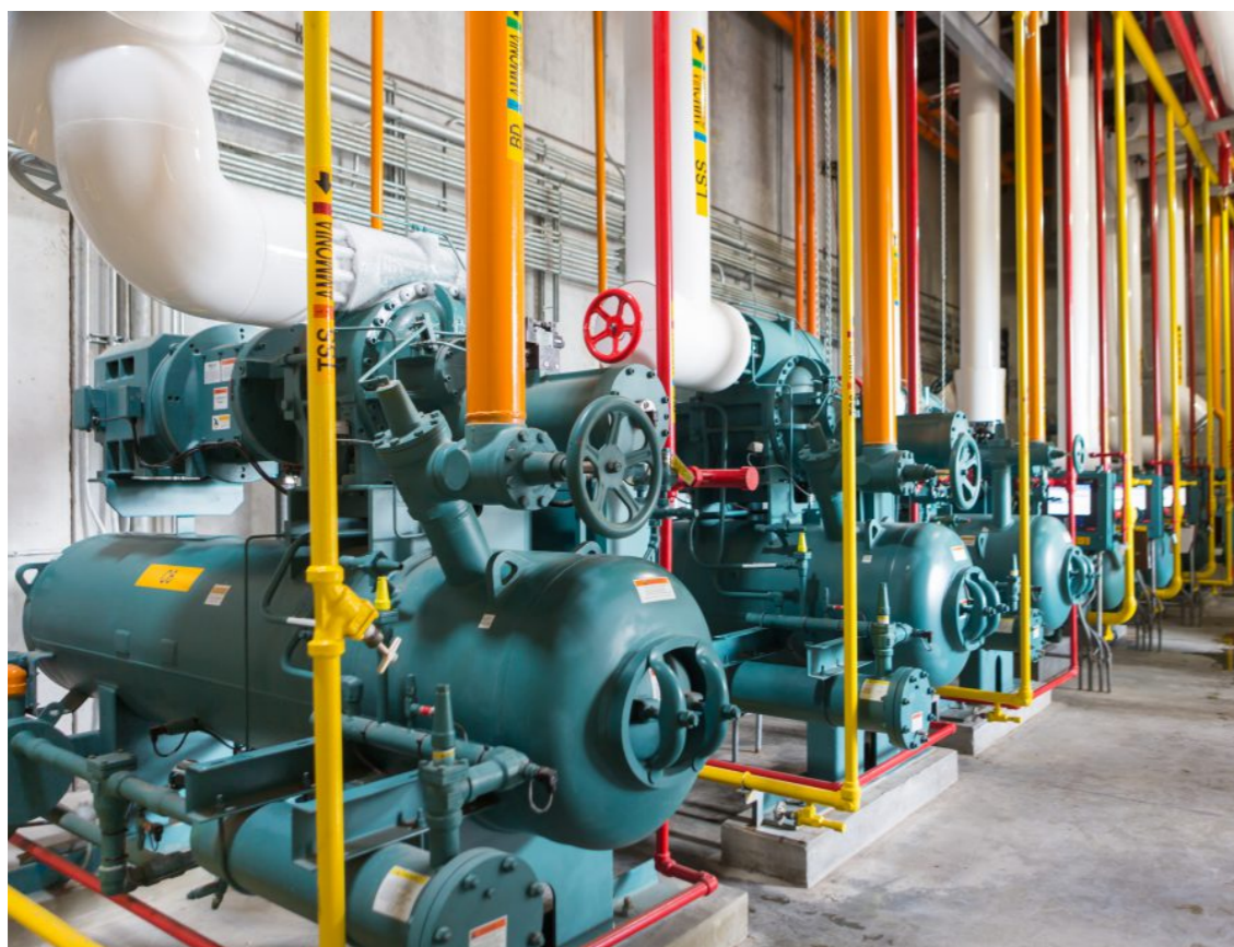
SALLE DES MACHINE NH 3
